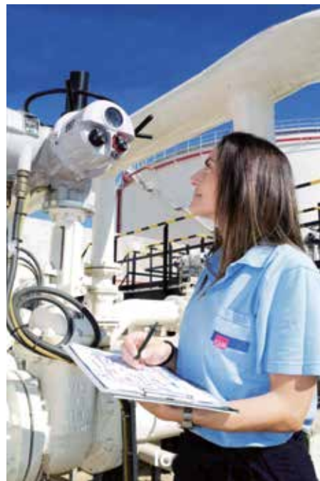
MOV 闸阀-西班牙CLH现场
