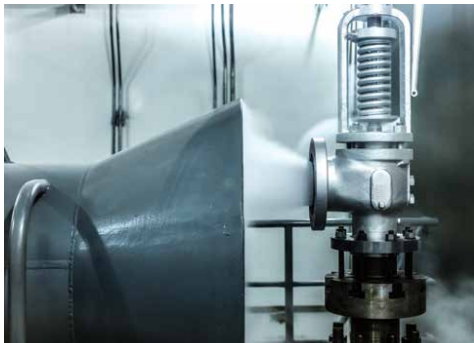
安全阀蒸汽测试中心能对安全阀按照ASME（美国机械工程师协会）锅炉和压力容器规范第I篇的要求进行生产测试
